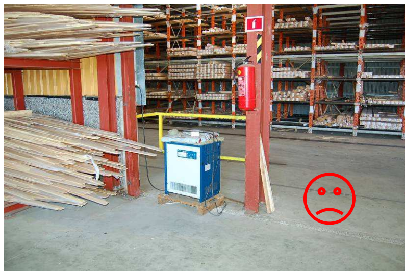
Figur 12. Avstand fra ladestasjoner til brennbart materiale skal være minst 2 meter.
