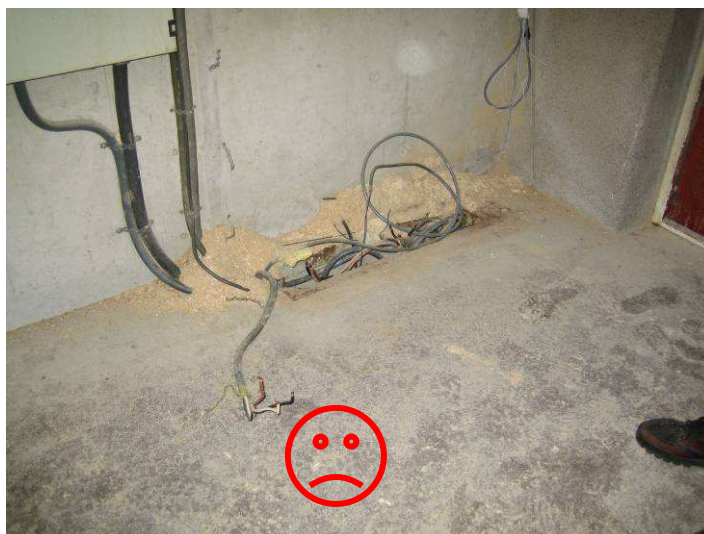
Figur 7. Løse ledningsender skal ikke forekomme.
