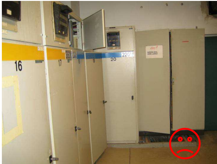
Figur 6. Sikringsskap skal holdes lukket.
