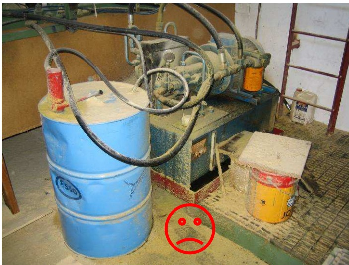
Figur 4. Det vil alltid forekomme svetting og oljelekkasjer ved hydraulikkapparater. Hyppig rengjøring er nødvendig for å redusere brannspredningen ved et eventuelt branntilløp.
