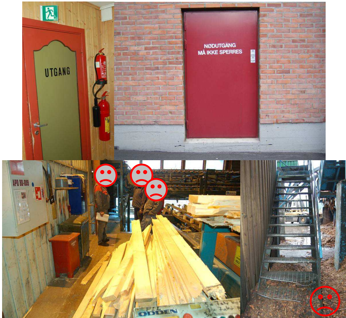
Figur 23. Rømningsveier må være merket. De må være ryddige og fri for lagret materiale, avfall, emballasje og inventar.
